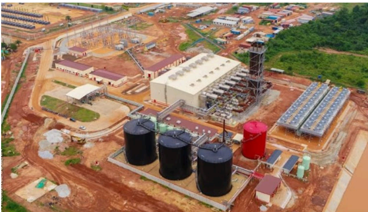
Vue du ciel de la centrale thermique de Maria Gléta dans la commune de Abomey Calavi
